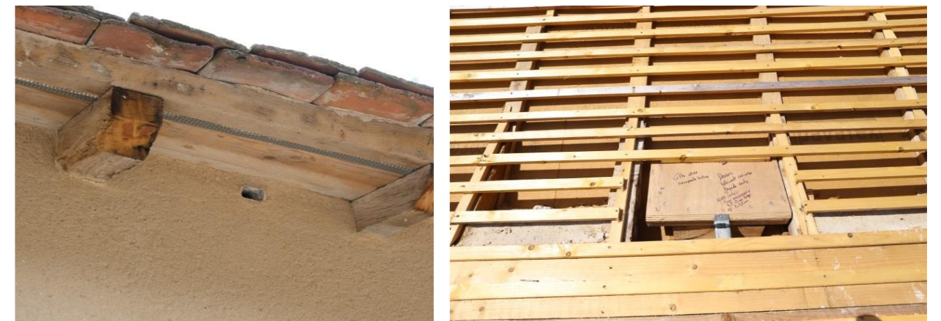
Gîte à chauve-souris directement intégré dans la toiture lors de sa réfection – Maison de la Rénovation, Le bouchet, Rosnay
